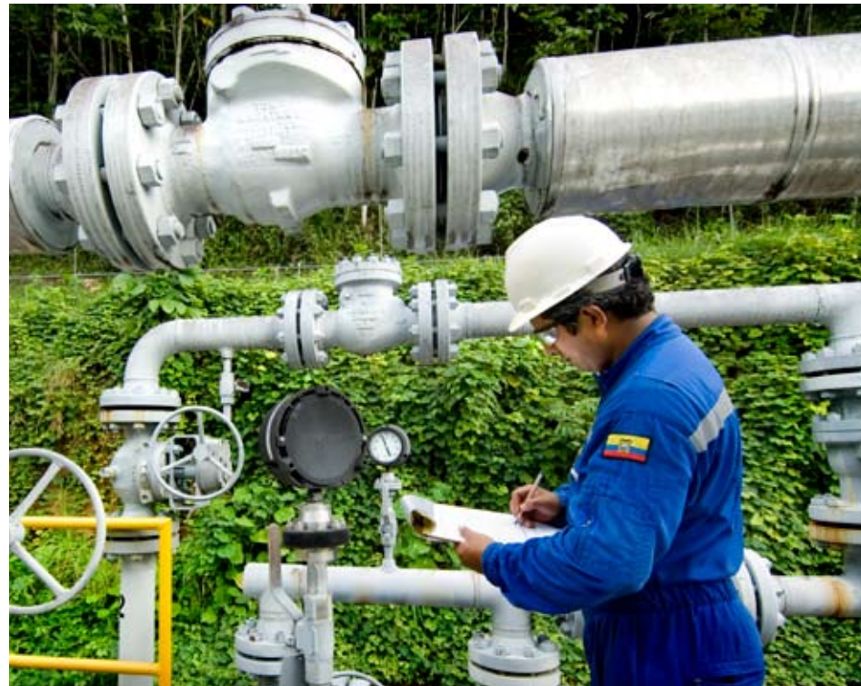
Instalaciones de Repsol YPF en Colombia.
